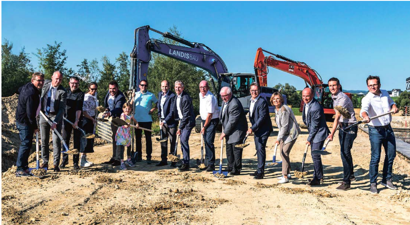
Bereit für den grossen Wurf: Stefan Baumgartner (mitte) nimmt mit seiner Familie und illustren Gästen den Spatenstich vor. (v.l.n.r.): Regierungsrat Beat Villiger, Regierungsrat Stephan Schleiss, Architekt Christoph Steiger, Landschaftsarchitektin Blanche Keeris, Regierungsrat Florian Weber, Ilana Baumgartner, Adrian Baumgartner, Fabian Baumgartner, Stefan Baumgartner, Thomas Baumgartner, Fredy Müller, Christoph Müller, Kantonsratspräsidentin Esther Haas, Beat Stocker (Alfred Müller AG), Manuel Liechti (Alfred Müller AG), Ruedi Zurbrügg (Präsident Energiestadtcommission Cham). Bild pd.
